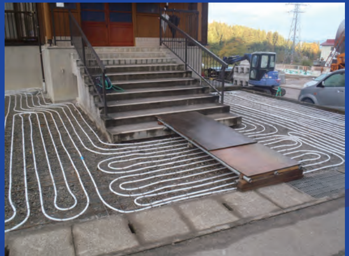
駐車場融雪配管
