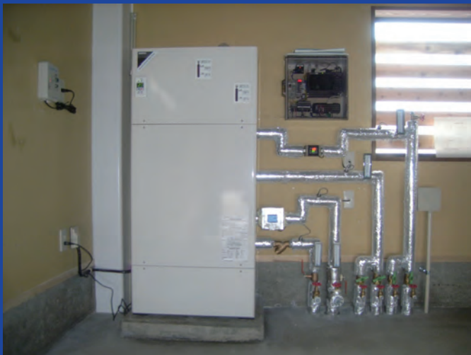
地中熱ヒートポンプ (車庫内に設置)
