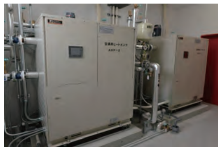
ヒートポンプ(室内)
