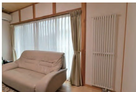
室内(パネルヒーター)
