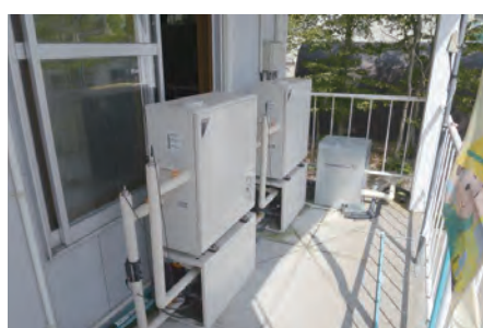
ヒートポンプ
