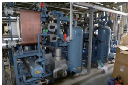
ヒートポンプ(室内)
