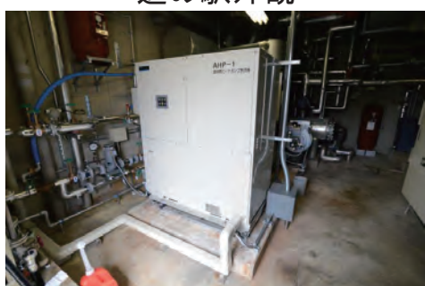
ヒートポンプ(室内)
