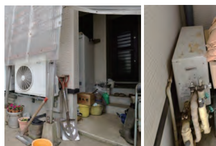
ヒートポンプ(地中熱+空気熱)
