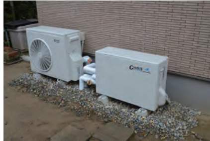
ヒートポンプ(地中熱+空気熱)
