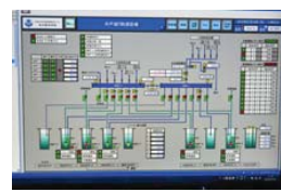
中央監視室の監視画面
