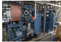
地中熱ヒートポンプ(計4台)
