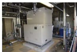
地中熱ヒートポンプ
