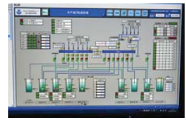
中央監視室の監視画面
