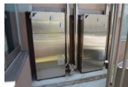
地中熱ヒートポンプ(10kW × 2台)
