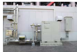
地中熱ヒートポンプ
