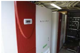
ヒートポンプ(130kW×3台)
