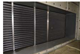
エアークーラー熱交換部
