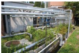
原水施設(揚水井、フィルター)
