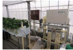
地中熱ヒートポンプシステム
