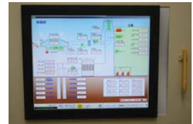
遠隔監視制御対応のモニター
