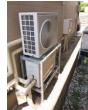
ヒートポンプ(地中熱+空気熱)
