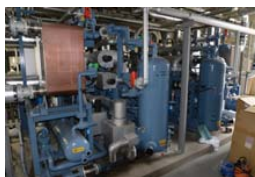
地中熱ヒートポンプ(計4台)
