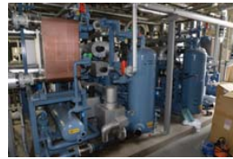
地中熱ヒートポンプ(計4台)
