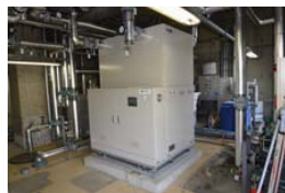
地中熱ヒートポンプ
