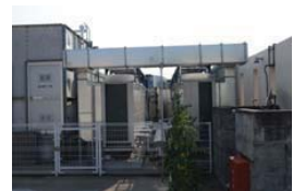
空気熱源ヒートポンプ(EHP)
