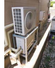
ヒートポンプ(地中熱+空気熱)
