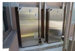
地中熱ヒートポンプ(10kW × 2台)
