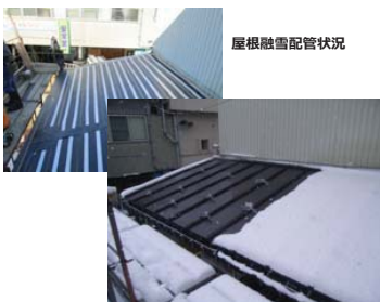
融雪運転状況
